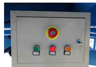
电气控制 Electrical control
