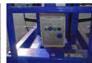
控制面板 Control Panel
